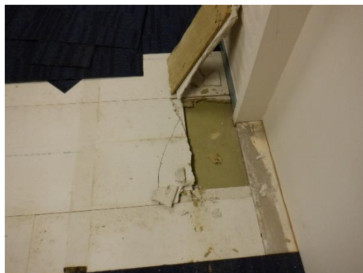
Foto niet verdachte vezelplaat als ondervloer kelder
