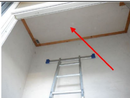
Foto 38 | Foto voor bron Plafond beplating
