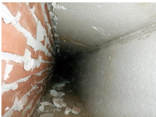
Foto ruimte tussen metselwerk en betonelementen gevel
