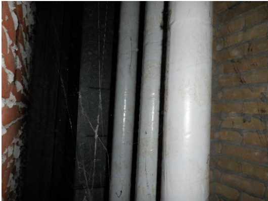
Foto binnenzijde leidingkanaal
