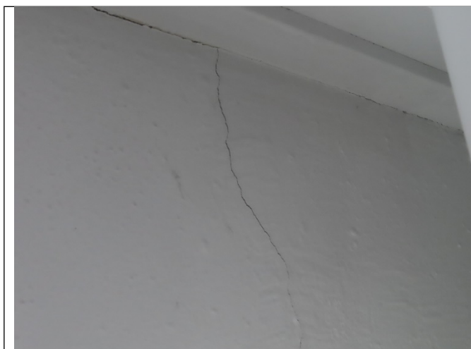
Foto 1 toont beschadiging rechts boven raamkozijn slaapkamer links achter d.d. 25 mei 2022
