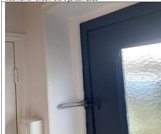
Foto 9 toont lichte scheurvorming tussen aftimmering en stukwerk rondom voordeur aan de linkerzijde d.d. 9 januari 2023
