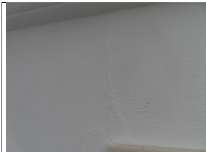
Foto 3 toont scheur achter stukwerk boven raamkozijn slaapkamer voorgevel d.d. 25 mei 2022
