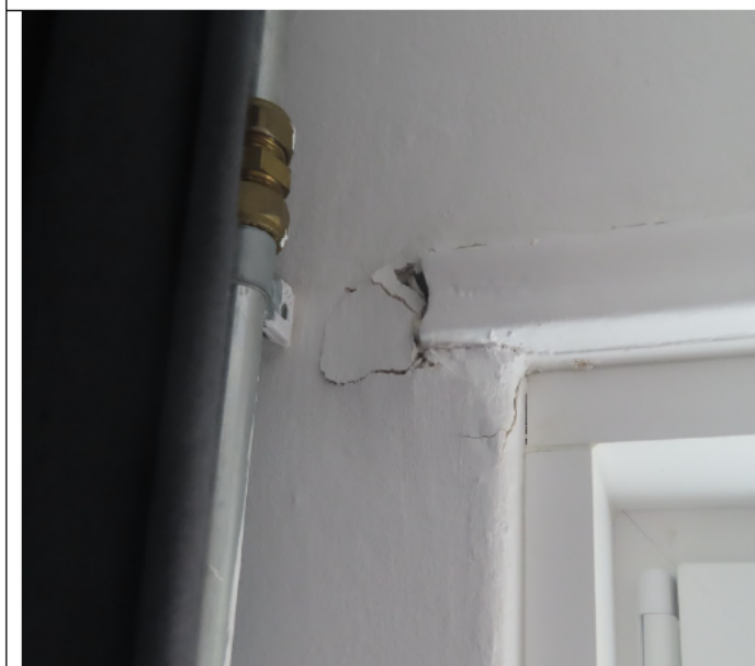
Foto 5 toont beschadiging in stukwerk boven raamkozijn slaapkamer rechts achter d.d. 25 mei 2022
