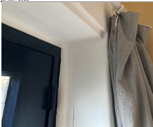
Foto 10 toont lichte scheurvorming tussen aftimmering en stukwerk rondom voordeur aan de rechterzijde d.d. 9 januari 2023
