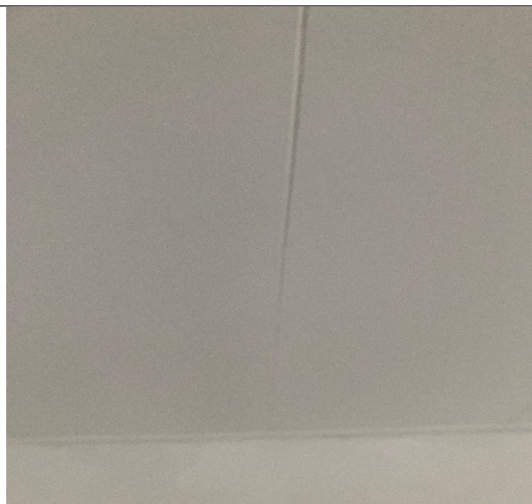
Foto 8 toont haarscheur tussen plafondplaten in woonkamer d.d. 9 januari 2023
