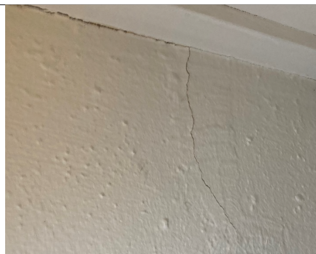
Foto 2 toont beschadiging rechts boven raamkozijn slaapkamer links achter d.d. 9 januari 2023
