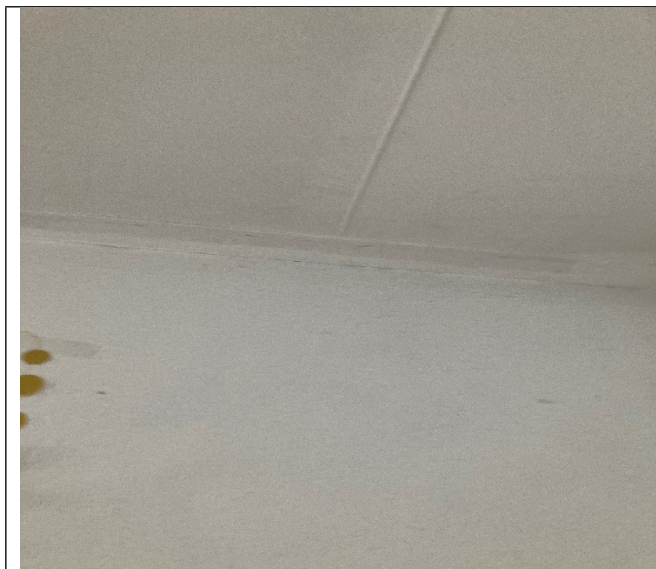
Foto 7 toont haarscheur tussen wand en plafondplinten in woonkamer rondom d.d. 9 januari 2023
