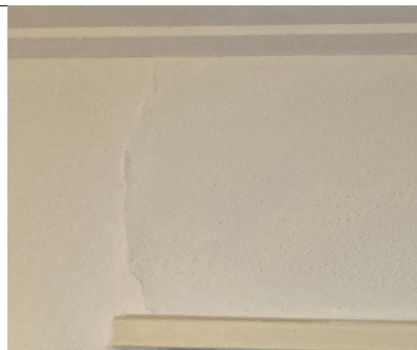
Foto 4 toont dezelfde scheur achter stukwerk boven raamkozijn slaapkamer voorgevel vanuit een andere hoek d.d. 9 januari 2023
