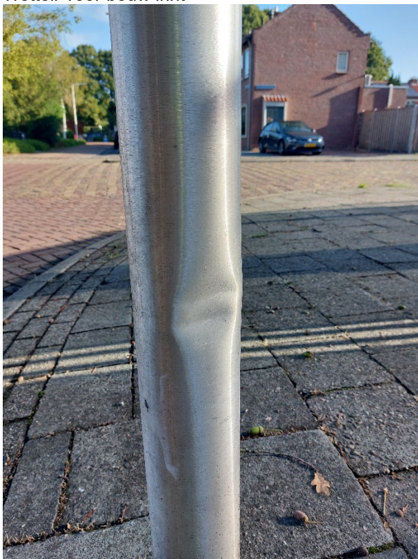
Lichtmast bij bouw inrit, schade aanwezig
