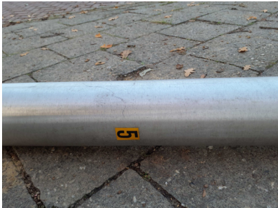
Foto 5 (Artikelnummer mast, binnenkant mastluikje)
